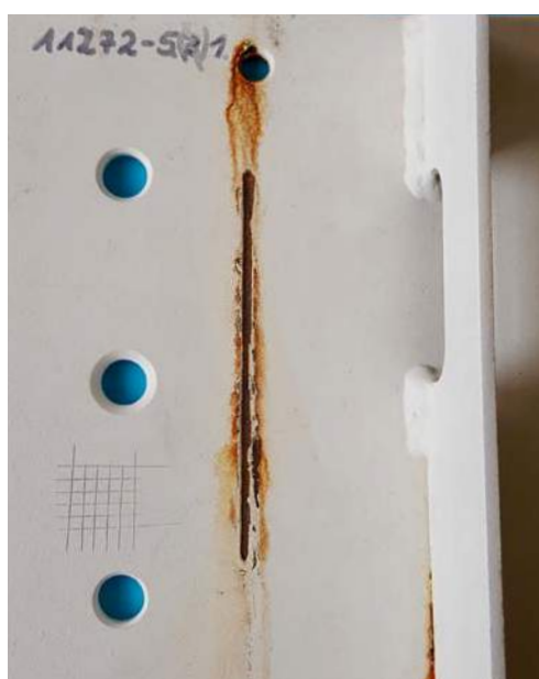
Abbildung 20: Detailansicht einer Probe, die die aktuell gültigen Normanforderungen einer C5 Korrosivitätskategorie erfüllt. Im Spalt sichtbare Korrosion könnte noch durch eine zusätzliche Abdichtung vermieden werden
