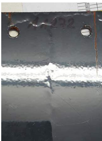
Abbildung 17: Korrosionsprobleme am Kantenbereich aufgrund nicht vorbereiteter Kanten
