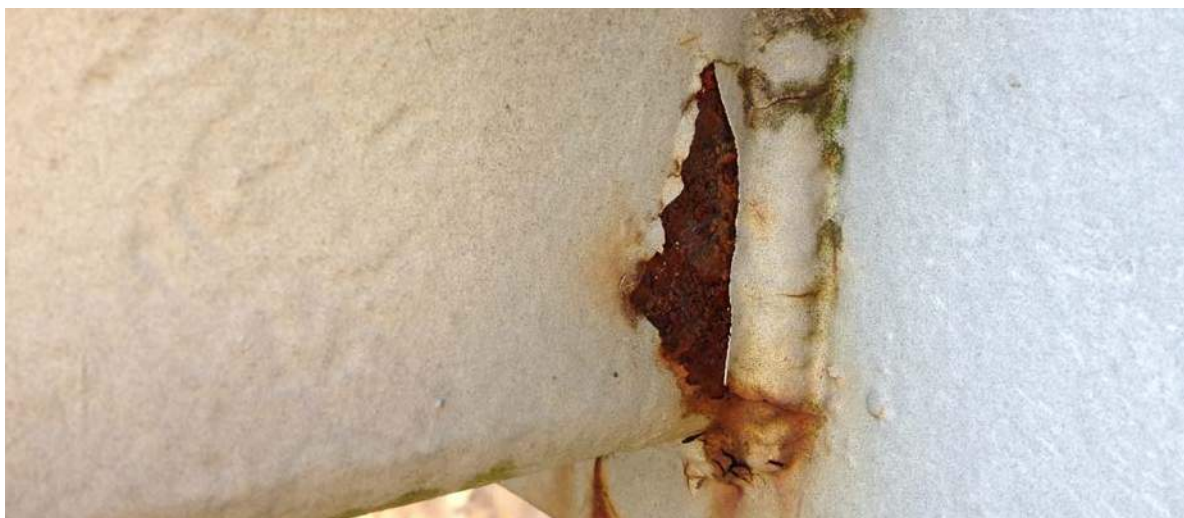
Abbildung 13: Beschichtungsschäden an einer nicht ordentlich gereinigten Schweißnaht
