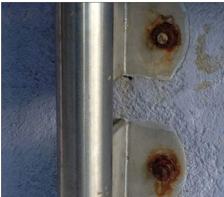
Abbildung 3: Beispiel für Kontaktkorrosion, Edelstahlgeländer verzinkter Verschraubung
