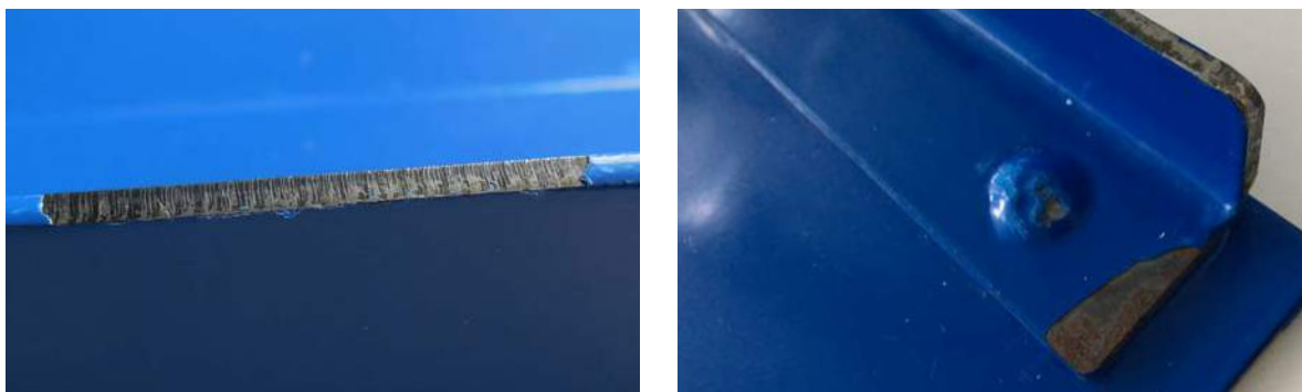
Abbildung 16: unbearbeitete Laserschnittkanten mit Korrosions- und Haftungsstörungen. Die Einschnitte des Lasers sind gut zu erkennen. Sich bildende Oxidschichten sind teilweise schwer durch chemische Vorbehandlungen zu entfernen. Mit Schutzgas arbeitende Lasersysteme können die Situation verbessern.
