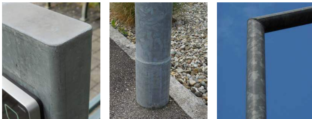
Abbildung 4: Beispiele für geschlossene Hohlbauteile. Links: Metallposten. Mitte und Rechts: Detailaufnahmen von Schweißnähten an einer Straßenlaterne
